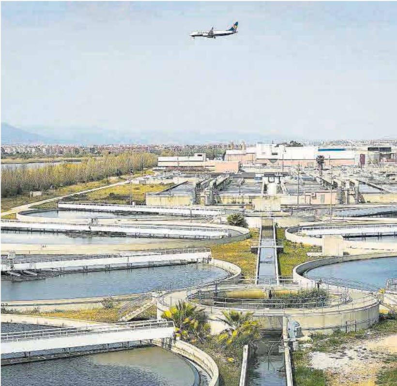
La planta depuradora (EDAR) de El Prat de Llobregat.
